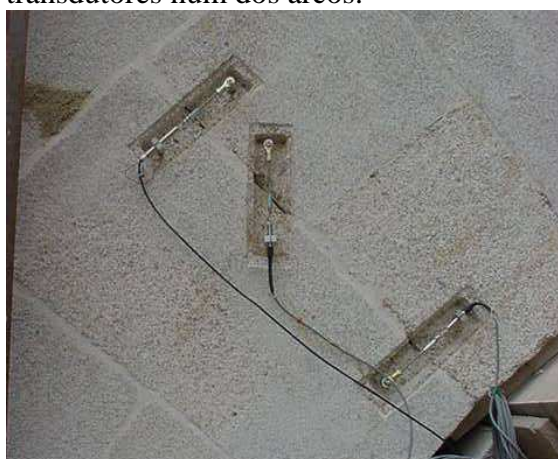
Figura 39a - Instrumentação de juntas. Configuração em Z dos transdutores de deslocamento.
