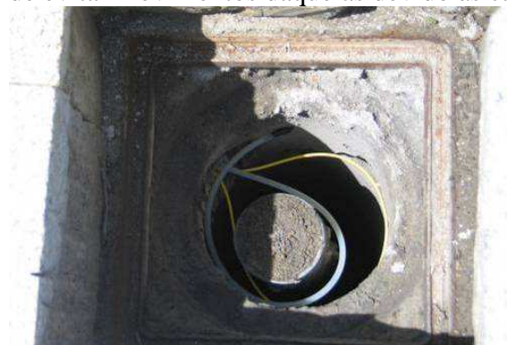
Figura 38a- Colunas de apoio aos sensores de pressão (vista superior).
