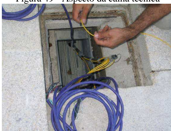
Figura 50 - Caixa de visita e de acesso à calha técnica
